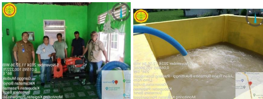
Gambar 21. Kondisi pompa dan aliran air ke bak penampungan.
