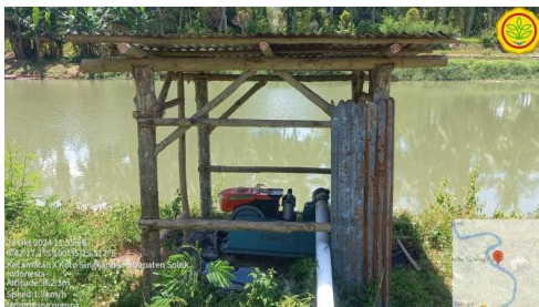
Gambar 6. Pompa bantuan yang terpasang di pinggir Batang Lembang.
